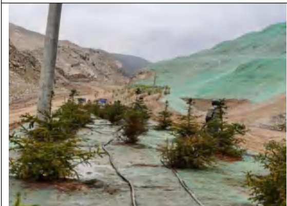
输电线路区植物、临时苫盖
